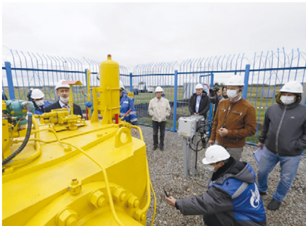
Испытания комплекса на крановых узлах магистрального газопровода Уренгой–Петровск
